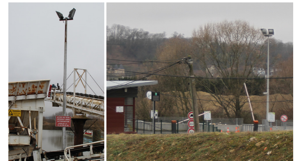
Exemples à ne pas suivre: l'orientation des projecteurs est mauvaise, elle induit une déperdition de lumière vers le ciel trop importante
