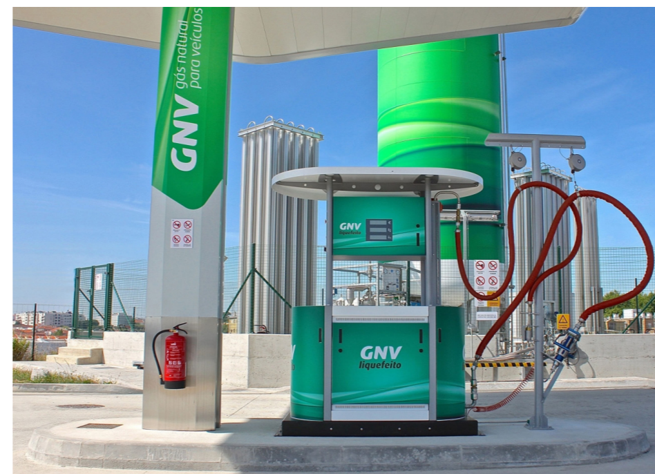
Station de carburant alternatif GNV
