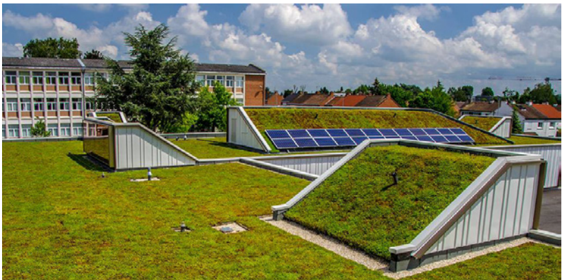
Toiture végétalisée associée à des panneaux photovoltaïques
