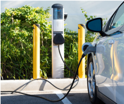
Borne de recharge électrique
