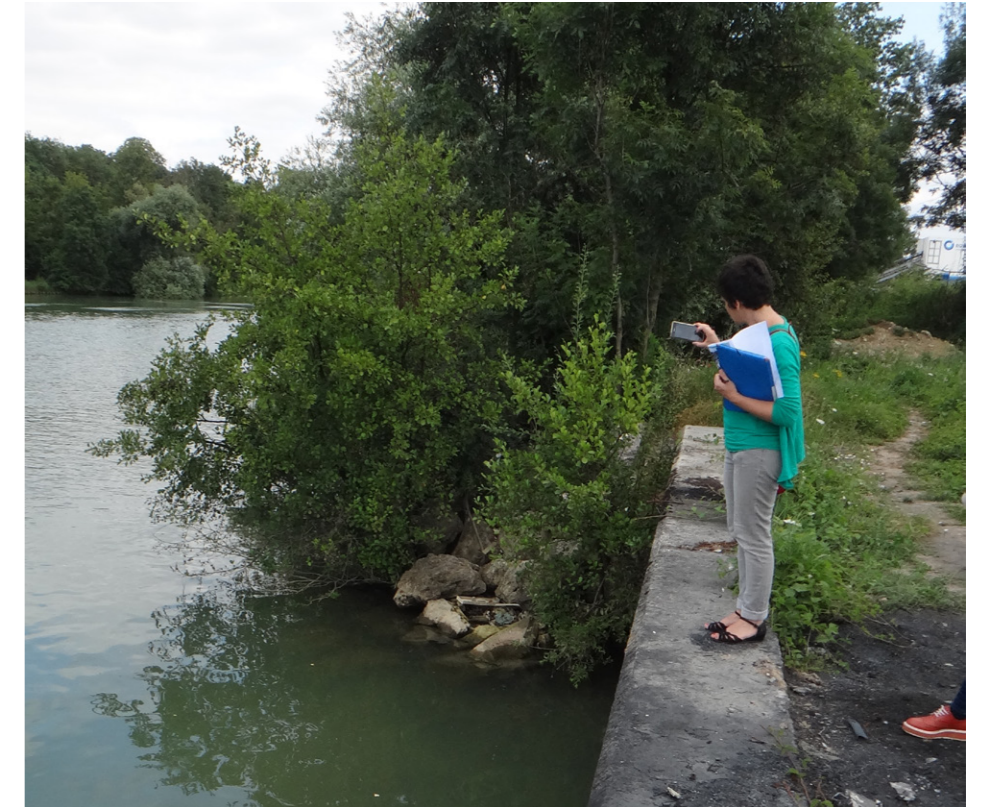
Berge effondrée, parcelle du 4 rue Freycinet
